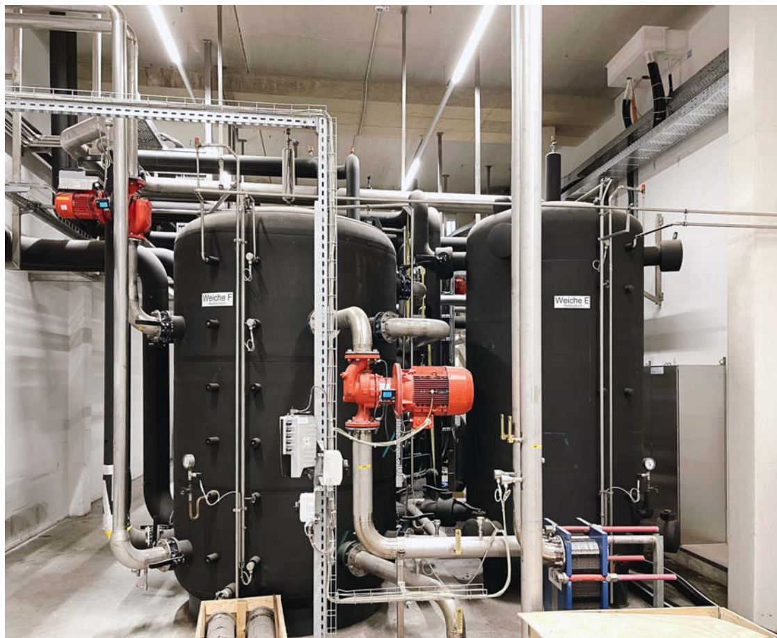
Das vernetzte Energiesystem bei Jellice: Mehrstufige Zorts-tröm-Einheiten koordinieren Wärme- und Kälteströme über verschiedene Temperaturniveaus hinweg.
