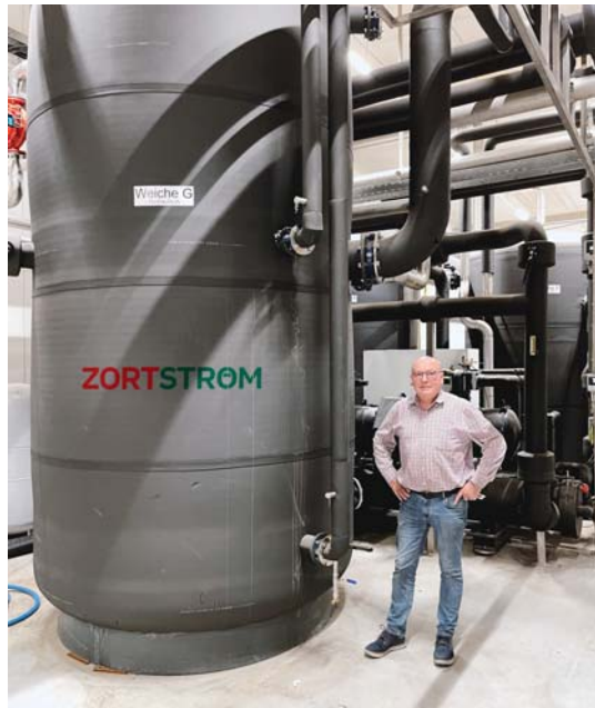
Zortström-Anlagen am Standort Emmen, Niederlande, bündeln und verteilen Wärme- und Kälteströme und ermöglichen eine präzise, effiziente Energieversorgung in der Gelatineproduktion.
