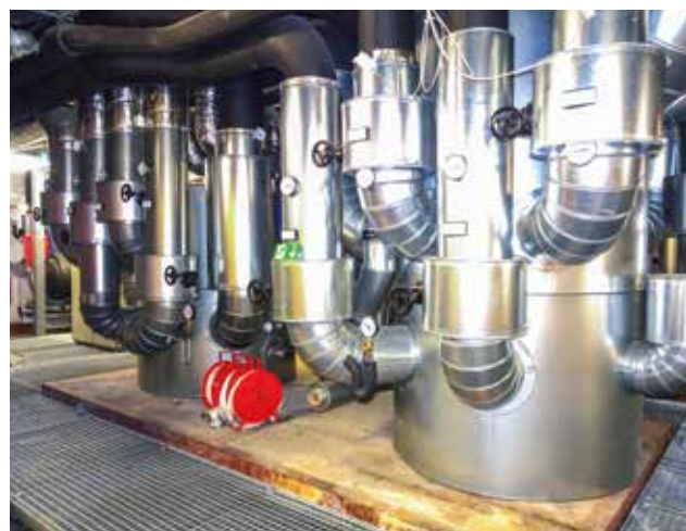
Zwei ZORTSTRÖM Multi (2- und 3-stufig) für die Kühlung
