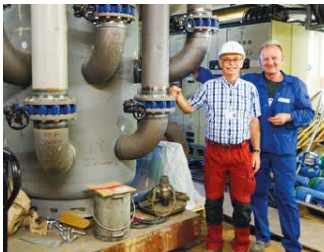
Der Planer Dip.-Ing. Harald Hess-Quint kontrolliert mit dem Chefmonteur Slobodan Marin den Einbau des ZORTSTRÖM
